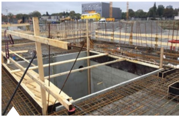
Risico Deel van de leuning ontbreekt. Gevaar Vallen van hoogte.
