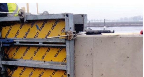
Risico Bij ontkistingswerkzaamheden is een medewerker met zijn oog tegen een centerpen aangelopen. Hij heeft hier wonden rond zijn oog aan overgehouden. Deze zijn in het ziekenhuis gehecht.
