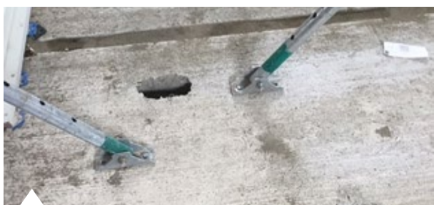
Risico Medewerker heeft bij het draaien van de dakkappen z'n enkel verzwikt. Om de dakkap te begeleiden moest hij over de knieschotten heen stappen die op de vloer liggen en daarbij is hij in een elektra sparing gestapt.
