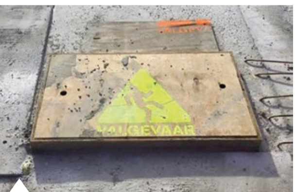
Risico Valgevaar. Oplossing Afdichting kruipluiken op de afgesproken wijze.
