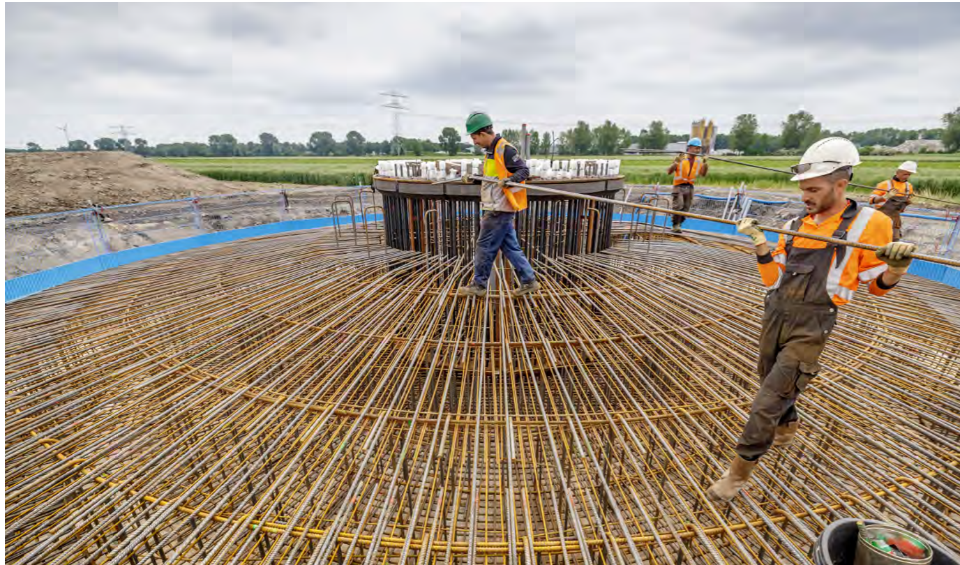
Windpark Zeewolde juni 2021
